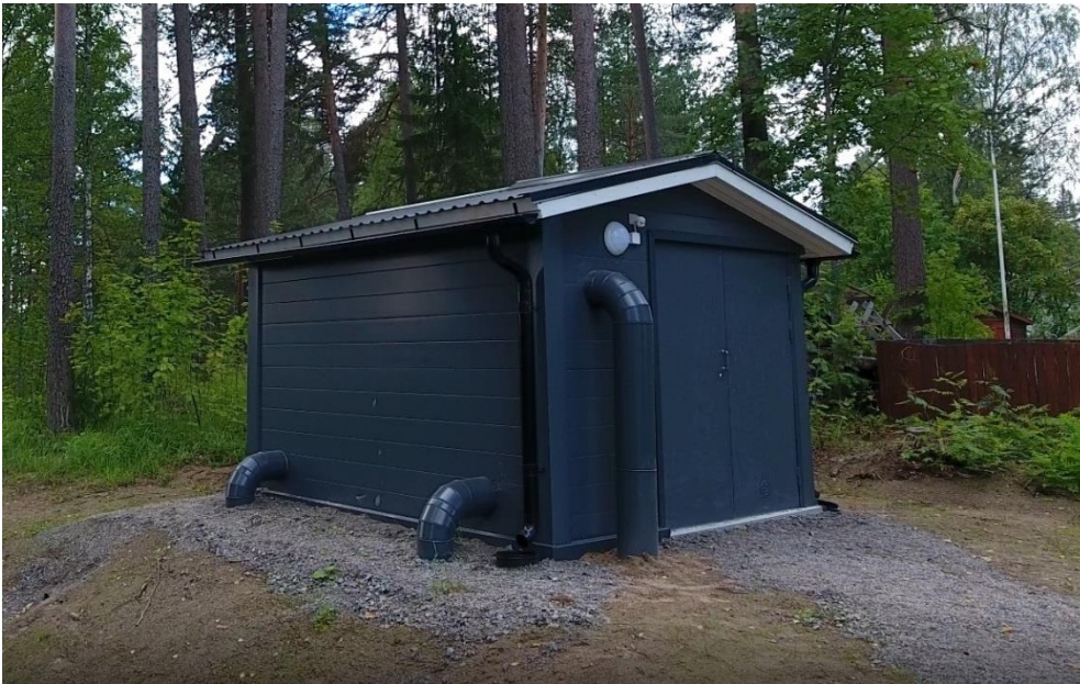
Kuva 1. Veikontien paineenkorotuspumppaamo (Kuva: Marko Rekola 2016)
