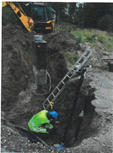
Kuva 3. Palopostin ja venttiilien asennusta Hietalahdessa. Kuvassa kesätyöntekijä Tuomo Linna (kuvaaja: Tiina Toivonen 2016)
